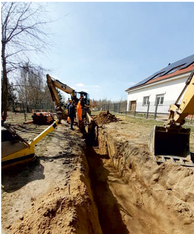
KIEKRZ ul. SARNIA WFOŚiGW POZNAŃ
