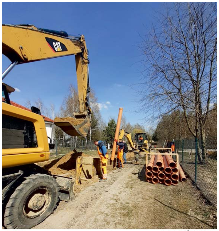
KIEKRZ ul. SARNIA WFOŚiGW POZNAŃ
