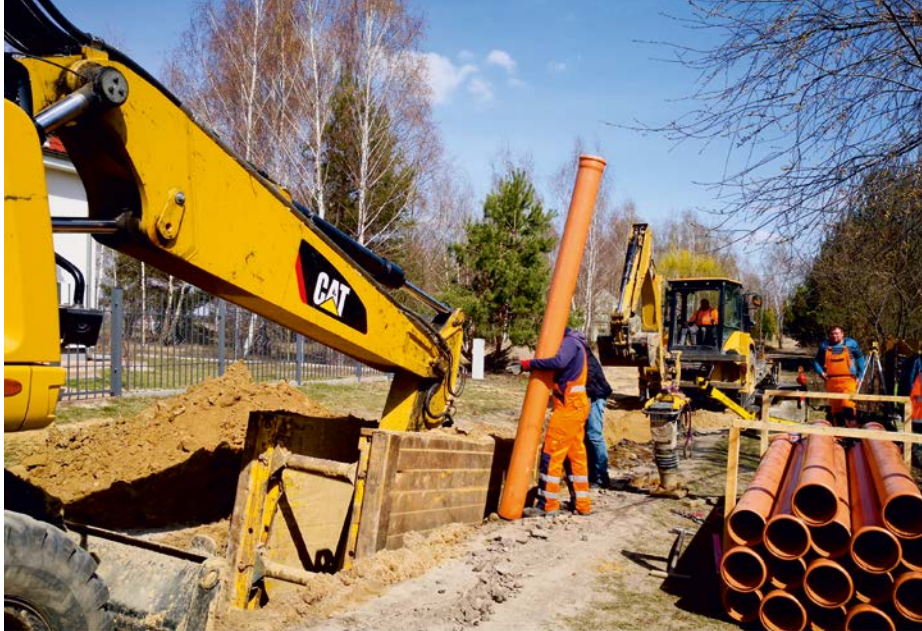
KIEKRZ ul. SARNIA WFOŚiGW POZNAŃ
