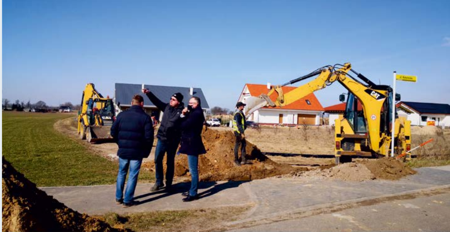
PK PRZEDSIĘBIORSTWO USŁUG KOMUNALNYCH Sp. z o.o. BUDOWA WODOCIĄGU KOBYLNIKI, UL. TARNOWSKA, 09.03.2021r.
